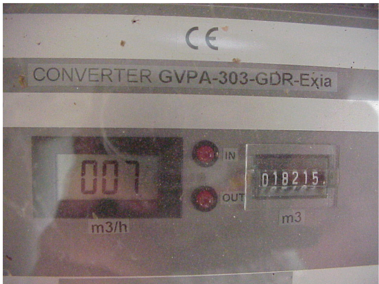
Abbildung 7.9: Rechengerät des Durchflusszählers
