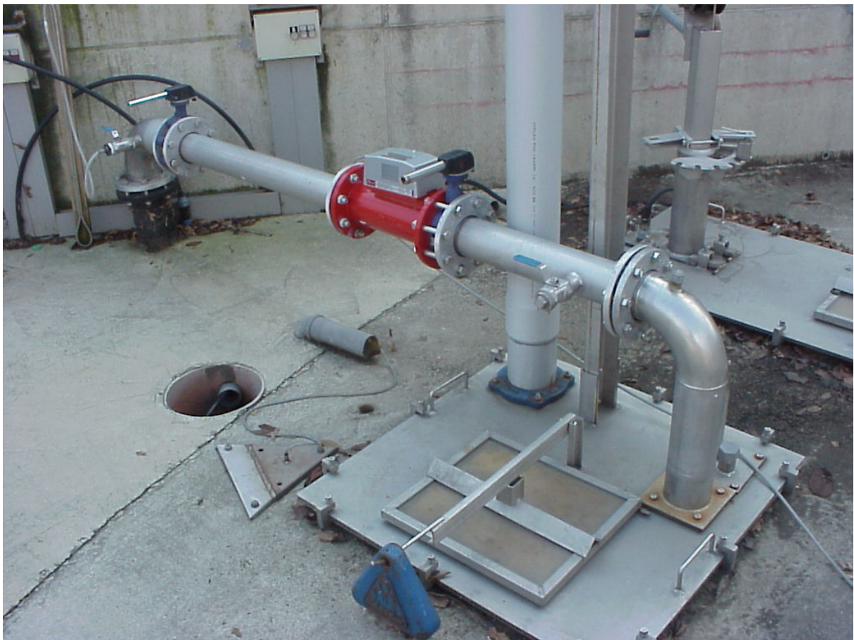
Abbildung 7.8: Durchflusssensor, Fa. ESTERS Elektronik, Type 005 GD 100 / 1 mit Rechengerät GVPA-303-GDR, zur Messung der Gasströmung zwischen dem Endlager und den übrigen Komponenten der Biogasanlage
